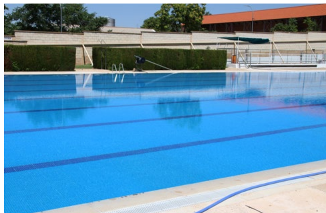
▲ La piscina olímpica perdía millones de litros por fugas
