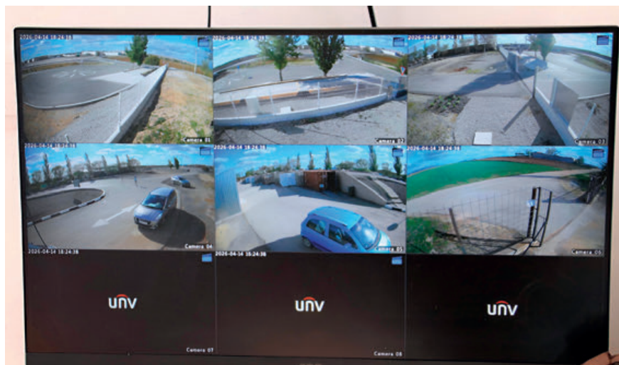
▲ Panel de control de vigilancia en el Punto Limpio.
