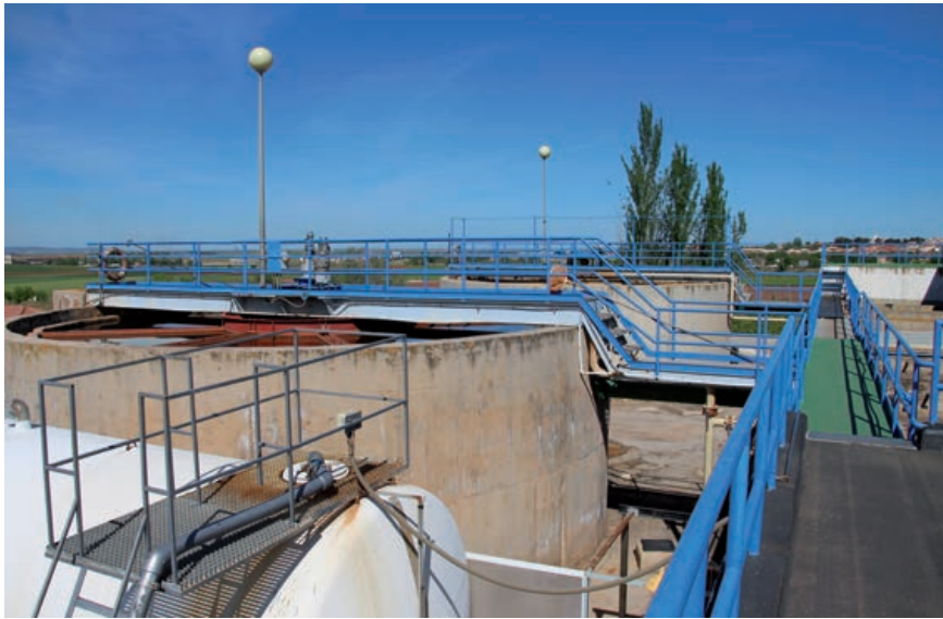
▲ Potabilizadora de aguas potables (ETAP).
